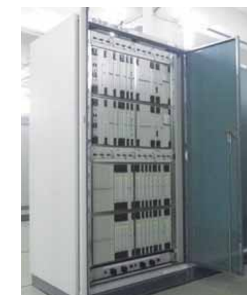
ネットワーク設備
