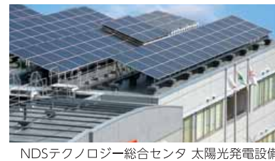
NDSテクノロジー総合センタ 太陽光発電設備
