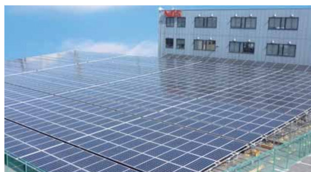
太陽光発電設備
