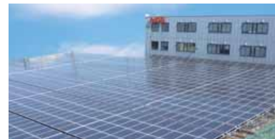
萱津ビル 太陽光発電設備
